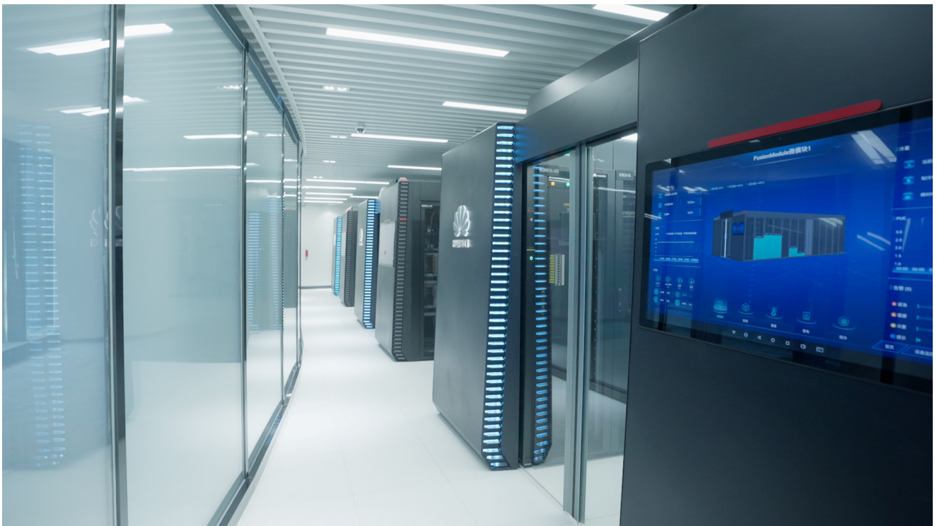
Seres Data Center
