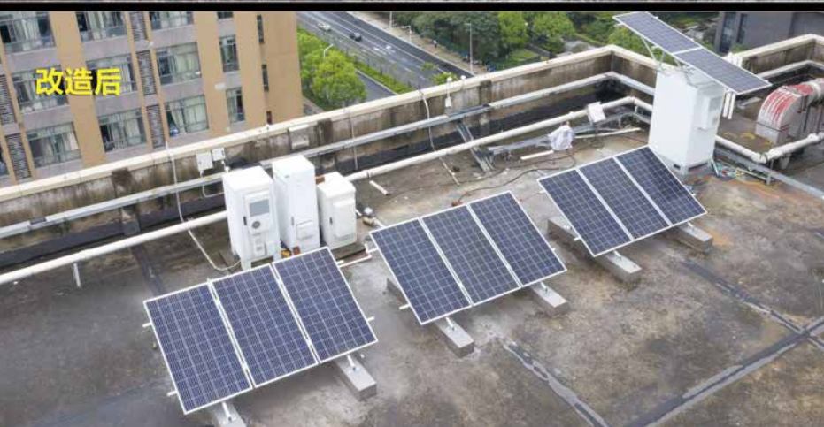
» 室外站点“1柜替6柜”改造前后对比
