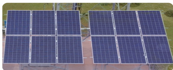
图:运营商通信站点绿电建设
