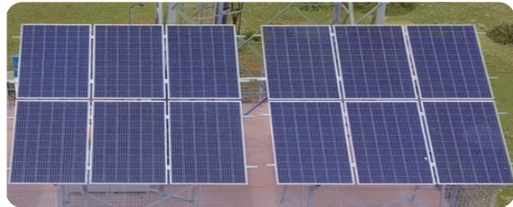
图:运营商通信站点绿电建设
